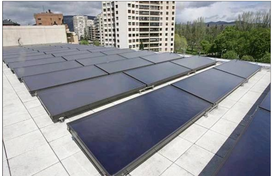
Placas solares en el centro cultural CIVICAN de Pamplona
